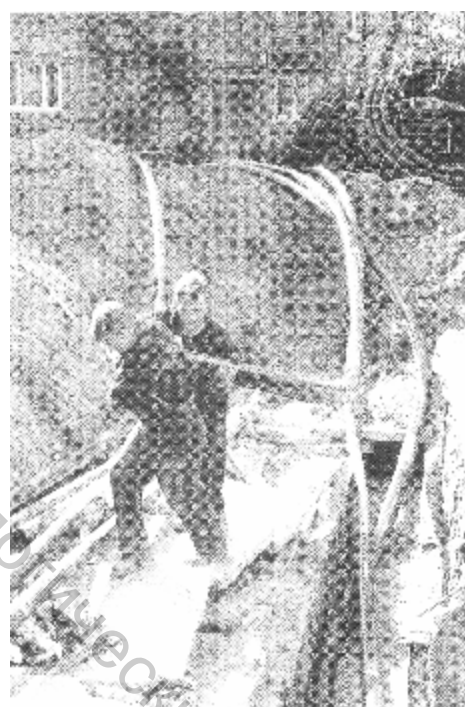
Рис. 4.4. Гибкие теплоизолированные полимерные трубы
